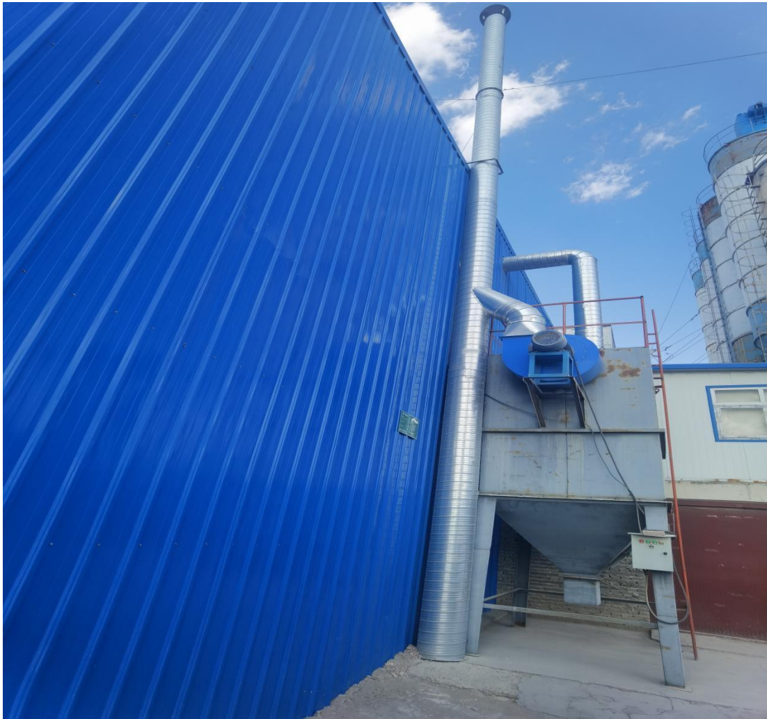
图 3-3 废气治理设施及排气筒
