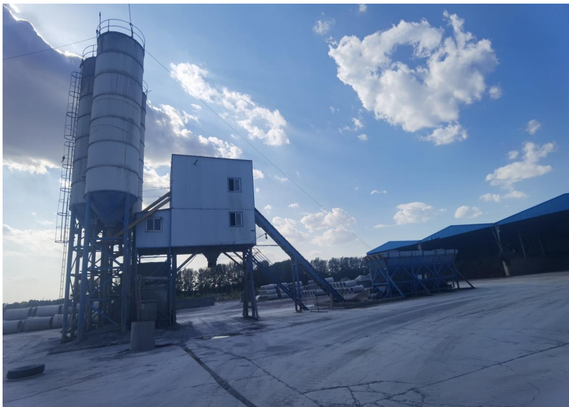
图 2-1 HZS90 混凝土生产线
