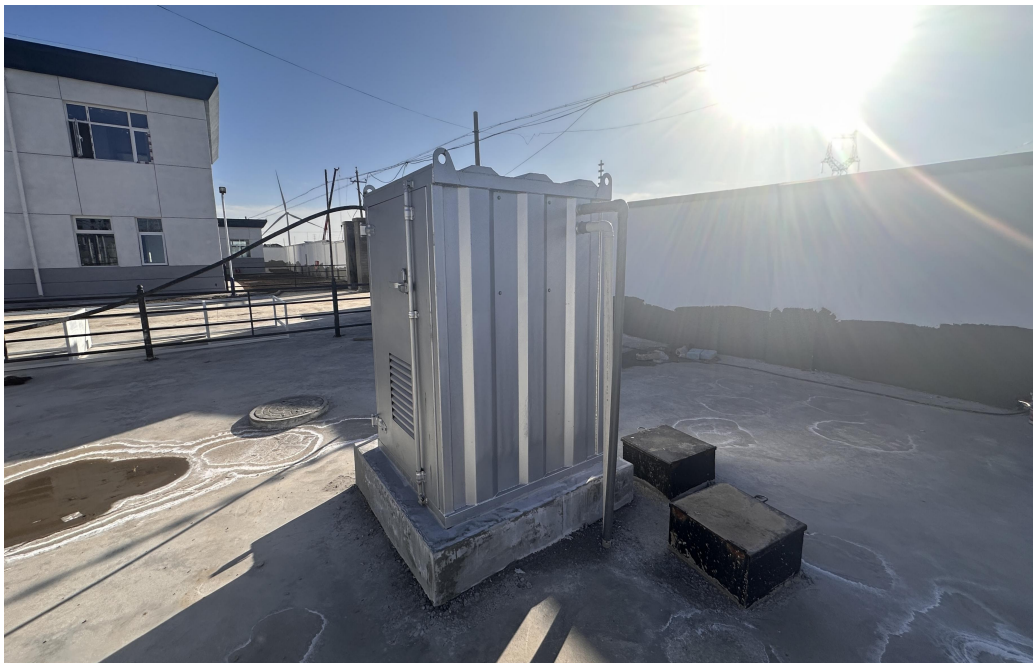
一体化污水处理装置
